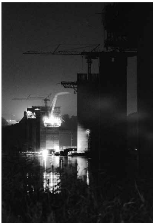
Glideforskallingen ved støbning af bropillerne gled ca. 25 cm frem ad gangen, så det tog omkring syv døgn at støbe en pille. FOTO JAN FRANDBSEN
